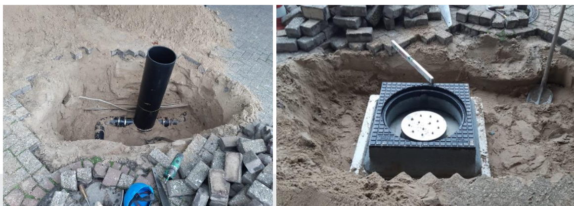
Foto's: Voorbeelden van voorzieningen voor controle van de bedrijfsriolering op waterdichtheid.
